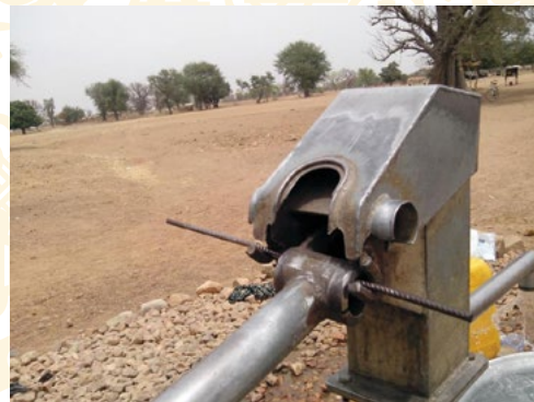
Versuch mit einfachen Mitteln die Pumpe am Laufen zu halten
