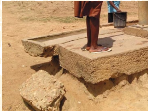
Durch Erosion beschädigte Pumpenplattform
